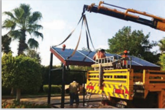
Şekil 4-4: Atatürk Parkı Güneş Enerjisi ile aydınlatma
